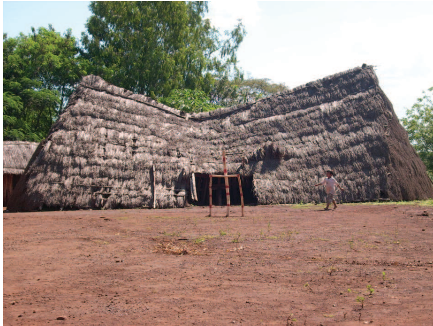
Figura 3 Og gusu com estrutura comprometida.
